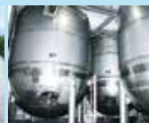
仕込みタンク
